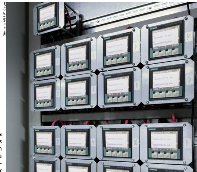
Zur Messung des Stromverbrauchs der Maschinen nutzt Fraisa Sentron PAC – insgesamt 24 Stück
